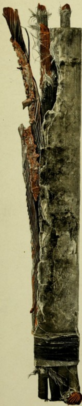
Fig. 160. Mikanthülse (mit innenliegenden Windungen) eines Generators. Durchschlag gegen das Eisengestell und darauffolgender Kurzschluß und Zerstörung.
