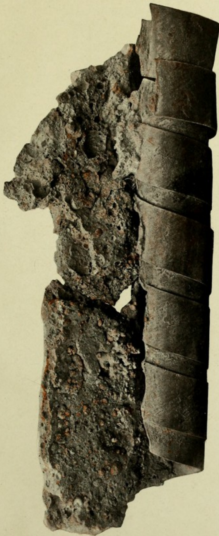
Fig. 230. Ein vom Blitz getroffenes (in der Erde liegendes) Bahnspeisekabel von 500 \text{ mm}^2 Querschnitt und 500 Volt Betriebsspannung; vollkommene Zerstörung, nur mehr Reste des Stahlpanzers.
