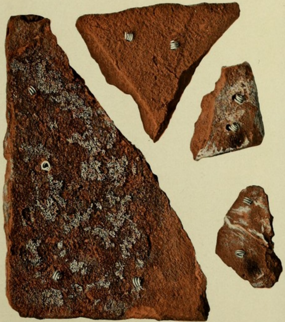
Fig. 210. Herausgebrochene Ziegelstücke des Daches und der Mauer (rechts: streifenförmig geschwärzt).
