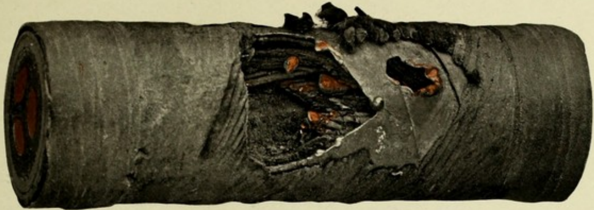
Fig. 164. Hochspannungskabel, 3 \times 150 \text{ mm}^2 Querschnitt und 5000 Volt Betriebsspannung. Durchschlag zwischen den Phasen infolge Überspannung.
