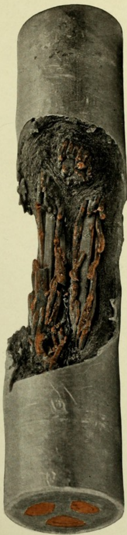
Fig. 161. Hochspannungskabel, 3 \times 150 \text{ mm}^2 Querschnitt und 5000 Volt Betriebsspannung. Kurzschluß und Zerstörung durch Stromübergang zwischen den Phasen innerhalb des Kabels.
