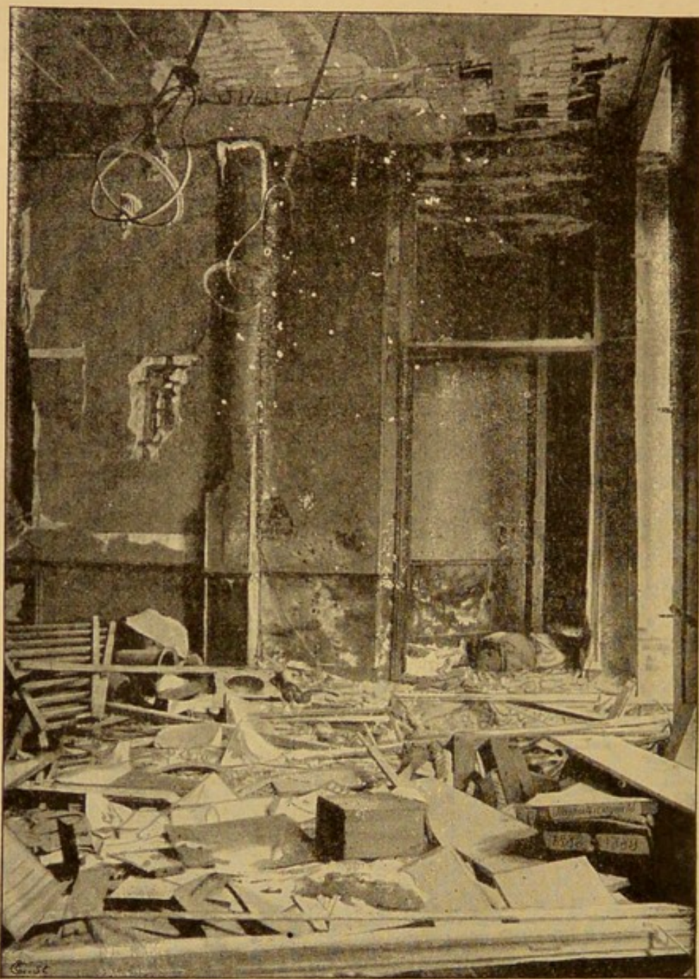
Fig. 38. — Salle du commissariat de police de la rue des Bons-Enfants, après l'explosion.
